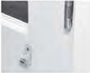
Instalación fuera de vano
